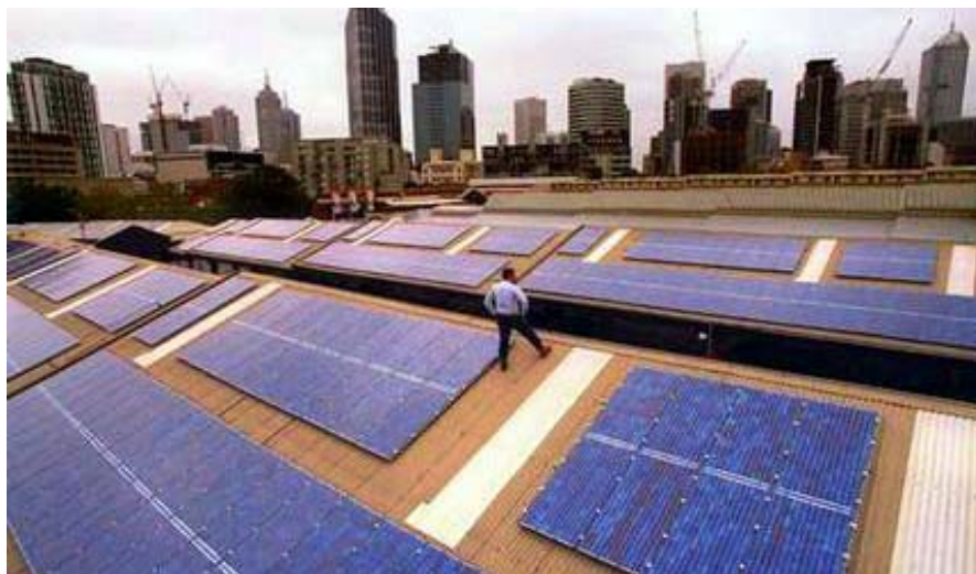
Figura 2. Celdas fotovoltaicas. Imagen tomada de energy.state.nv.us
